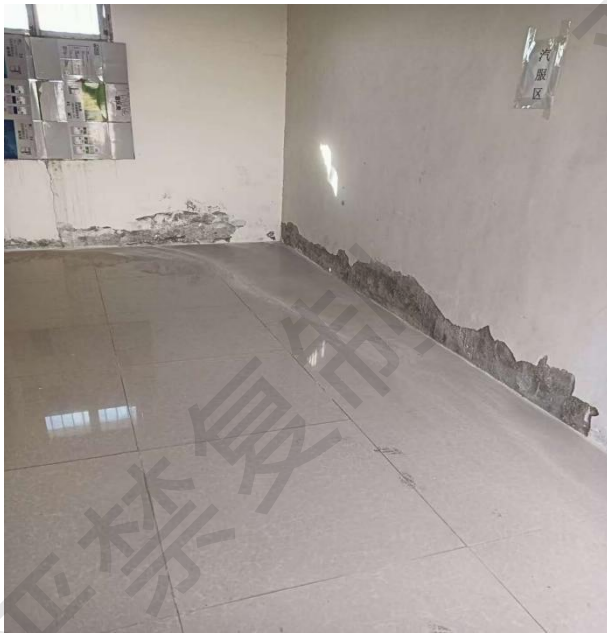
部分整改图片：
